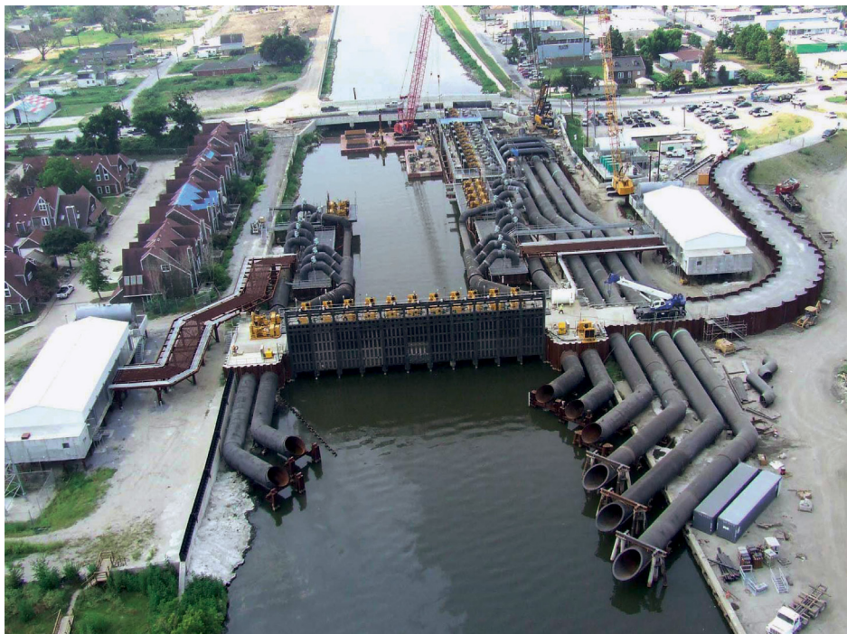
Figuur 12.5 Afsluiter en pompstation (interim) 17th Street uitlaatkanaal, bron: US Army Corps of Engineers, 2008.
